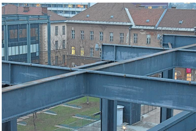
Slika 3: Točkovna korozija na zgornjih površinah profilov
