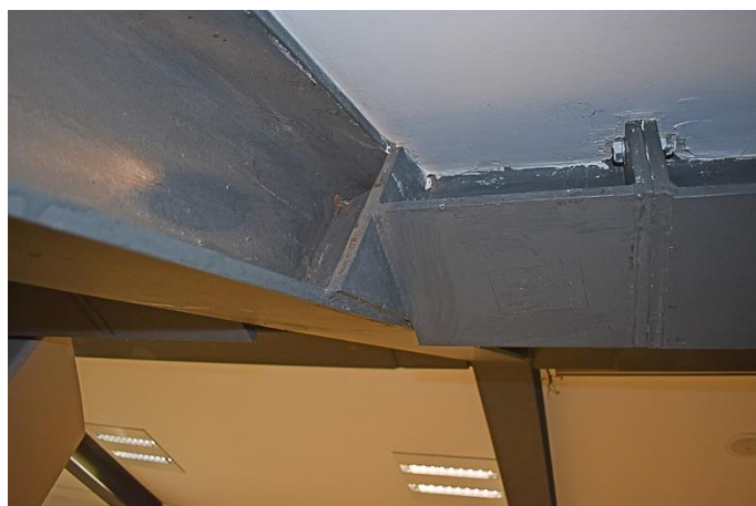
Slika 4: Slaba popravila po montaži (notranja konstrukcija)
