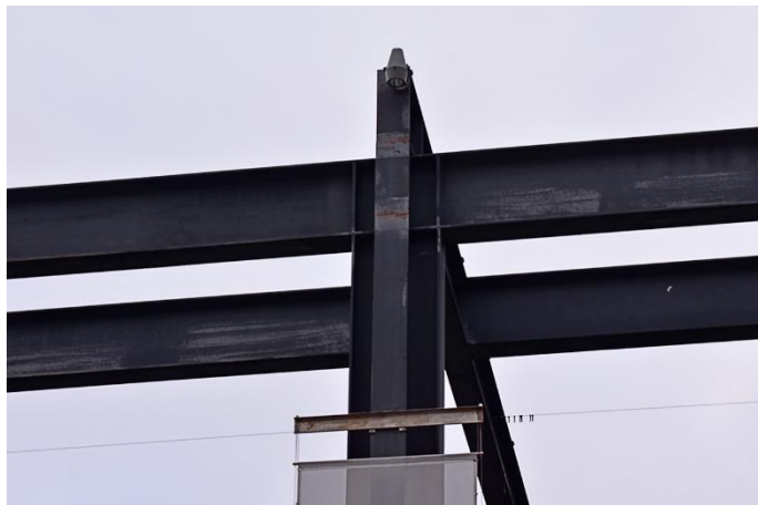
Slika 1: Korozija na popravljenih površinah vara
