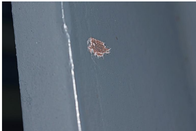
Slika 2: Ne-peskana podlaga (rja) pod premazom
